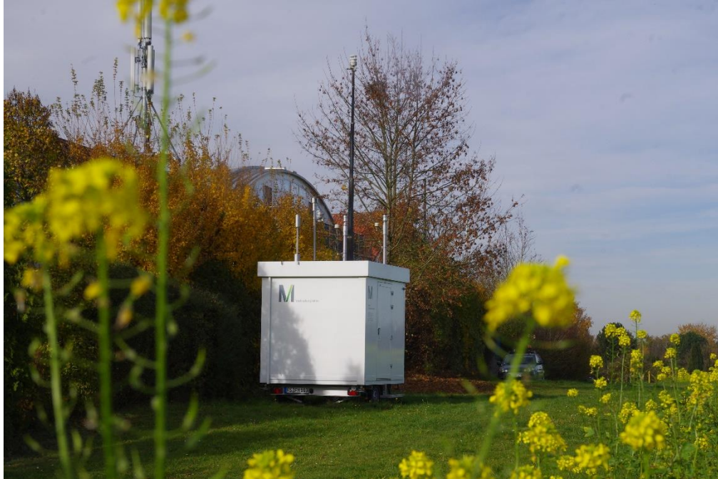
Außenansicht der mobilen LGM am Standort Haimhausen
